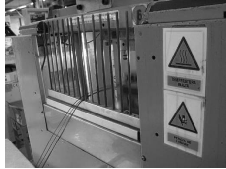
Fig. 6. Grilaj protecție mașină injectare Arburg C
